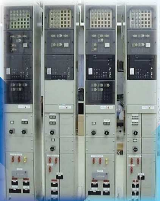
送電線保護継電装置
